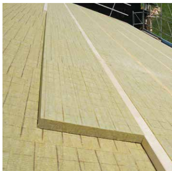
Struttura del tetto a due strati fino a 300 mm di spessore isolante.
