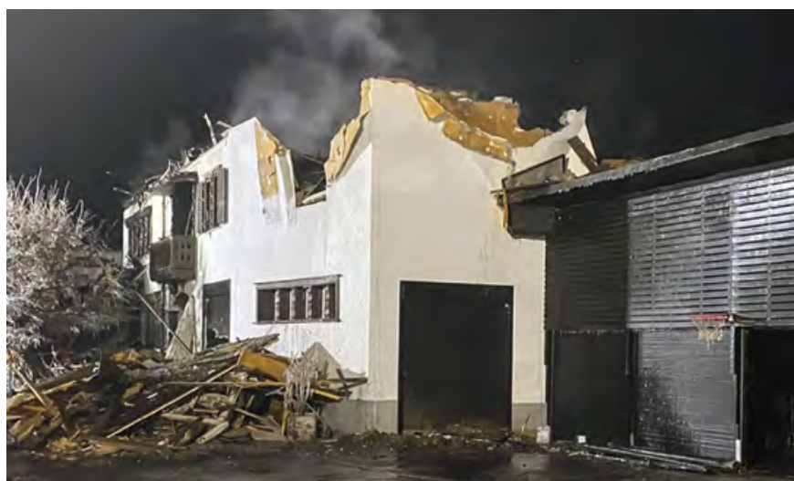
Nur das Erdgeschoss hielt dem Brand im Jahr 2022 stand. Es war rund 20 Jahre zuvor mit Flumroc-Steinwolle erneuert worden.
