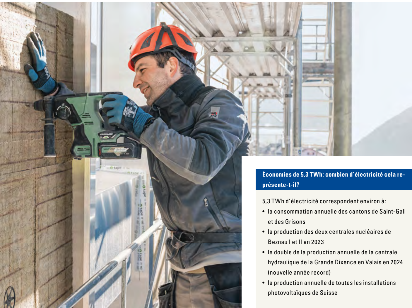
Si l'on incluait non seulement les maisons privées, mais aussi les bâtiments publics et commerciaux, le potentiel d'économies grâce à l'isolation serait encore plus important.
