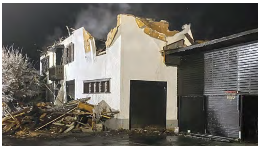
Seul le rez-de-chaussée a résisté au feu. Il avait été rénové avec de la laine de pierre Flumroc il y a environ 20 ans.
