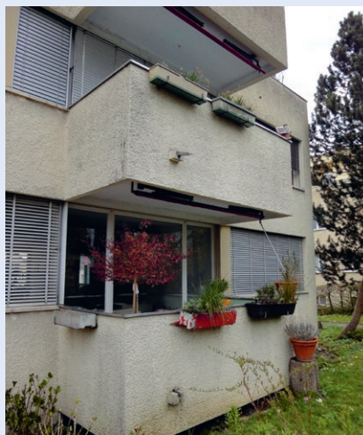
Les balcons avaient eux aussi besoin d'être renovés.
